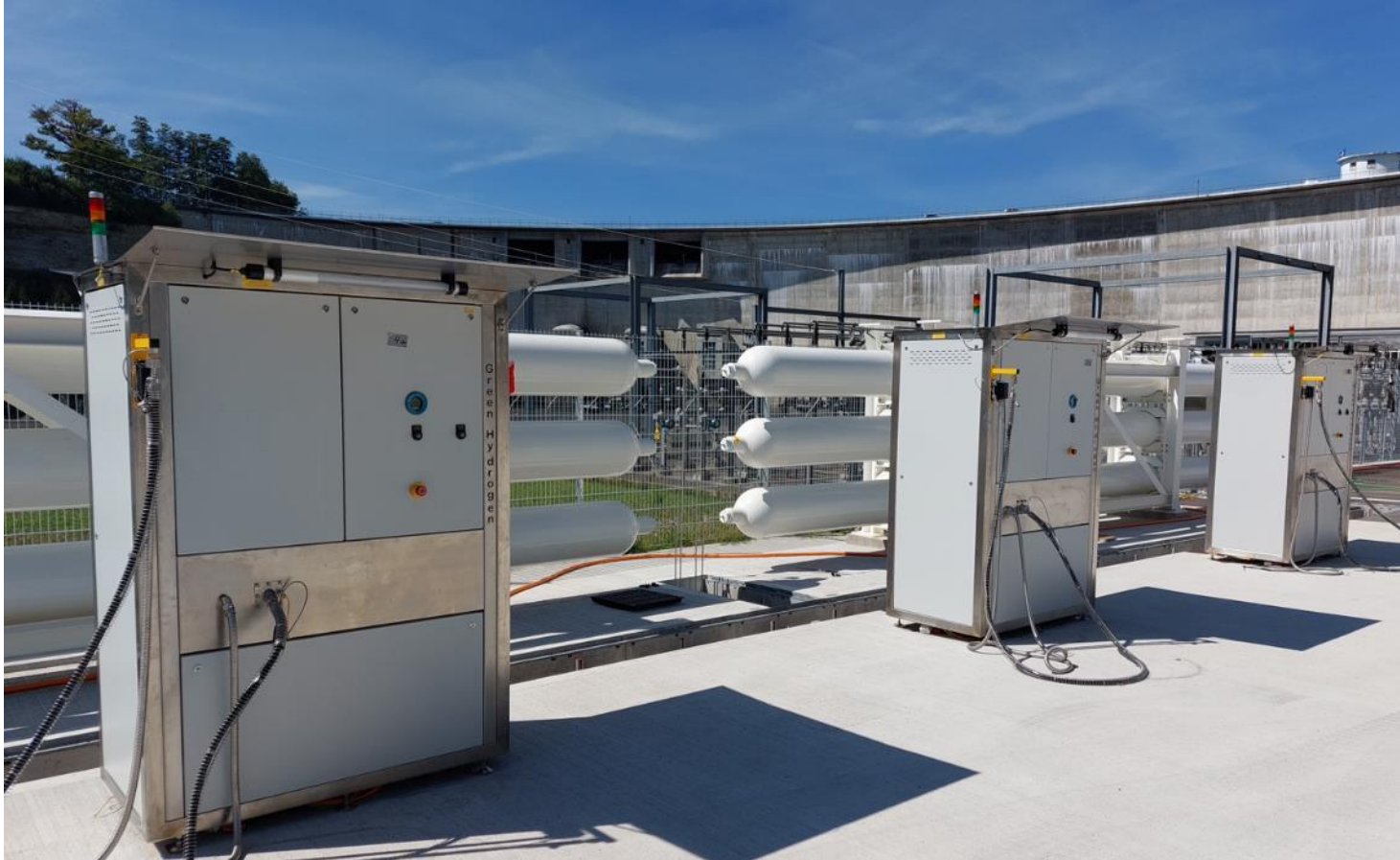
9 réservoirs de stockage et 6 stations de chargement
